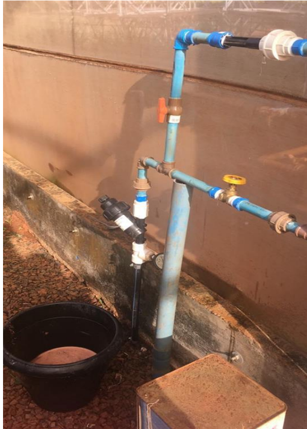
Figura 3. Filtro de discos e injetor Venturi utilizados na fertirrigação.
